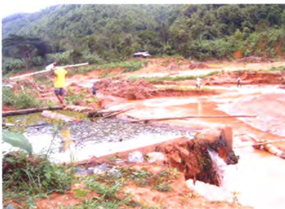
ชาวบ้านรับน้ำจากอาคารระบายน้ำล้นของสระน้ำภายในหมู่บ้านที่ถูกกีดเซาะได้รับความเสียหาย
