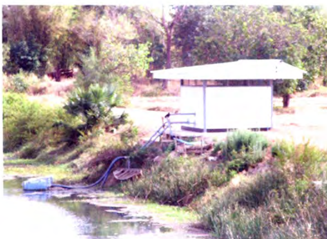
อบต.เตยได้สร้างโรงสูบน้ำดิบสำหรับระบบประปาหมู่บ้าน ซึ่งมีการสูบน้ำจากลำห้วยพระโรจน์เพื่อใช้เป็นแหล่งน้ำดิบ
