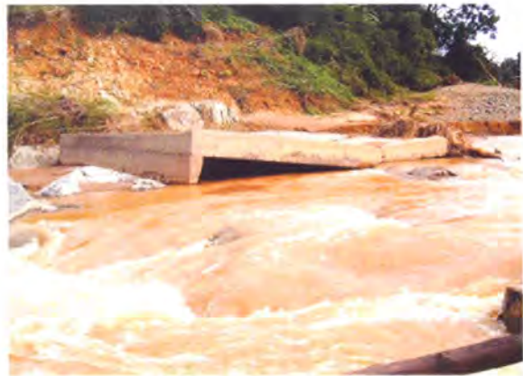
น้ำหลากพัดพาชิ้นส่วนสะพานคอนกรีตเสริมเหล็ก
