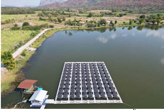
งานบำรุงรักษาโครงการระบบกระจายน้ำ พลังงานแสงอาทิตย์
